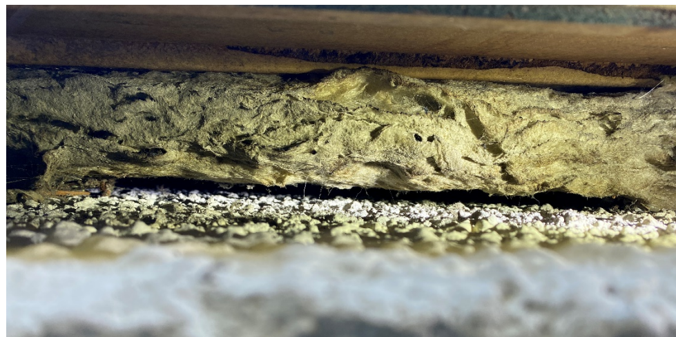
Figuur 38. Achter de gevelbetimmering bij nummer 307 is een grote opening te vinden zien. De ruimte is geïsoleerd met glaswol maar achter het glaswol zijn op sommige plaatsen voldoende ruimte om achter te kruipen.
