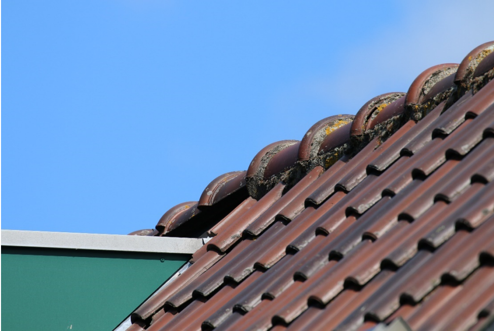
Figuur 34. Boven de dakkapel van woning nummer 307 sluiten de dakpannen niet goed aan. Vanaf de dijk gezien lijkt hier wel een bitumen afdekking aanwezig te zijn maar onduidelijk is of deze goed aansluit.
