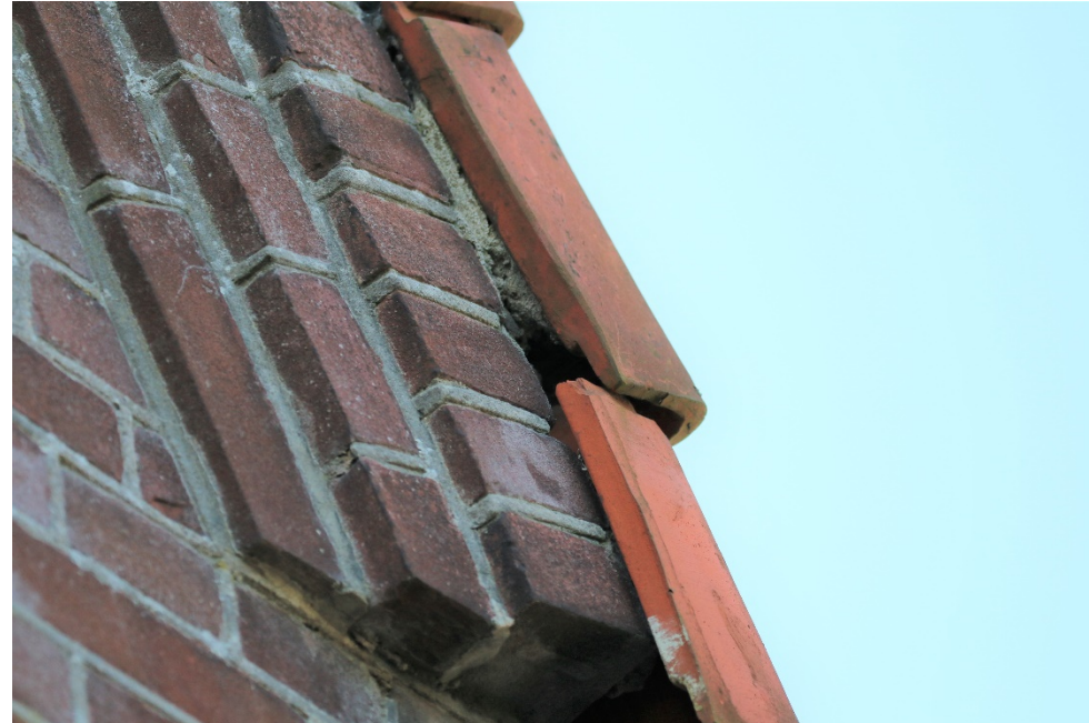
Figuur 37. Bij nummer 314 zijn er diverse kleine openingen te vinden die de woning toegankelijk maken voor vleermuizen.
