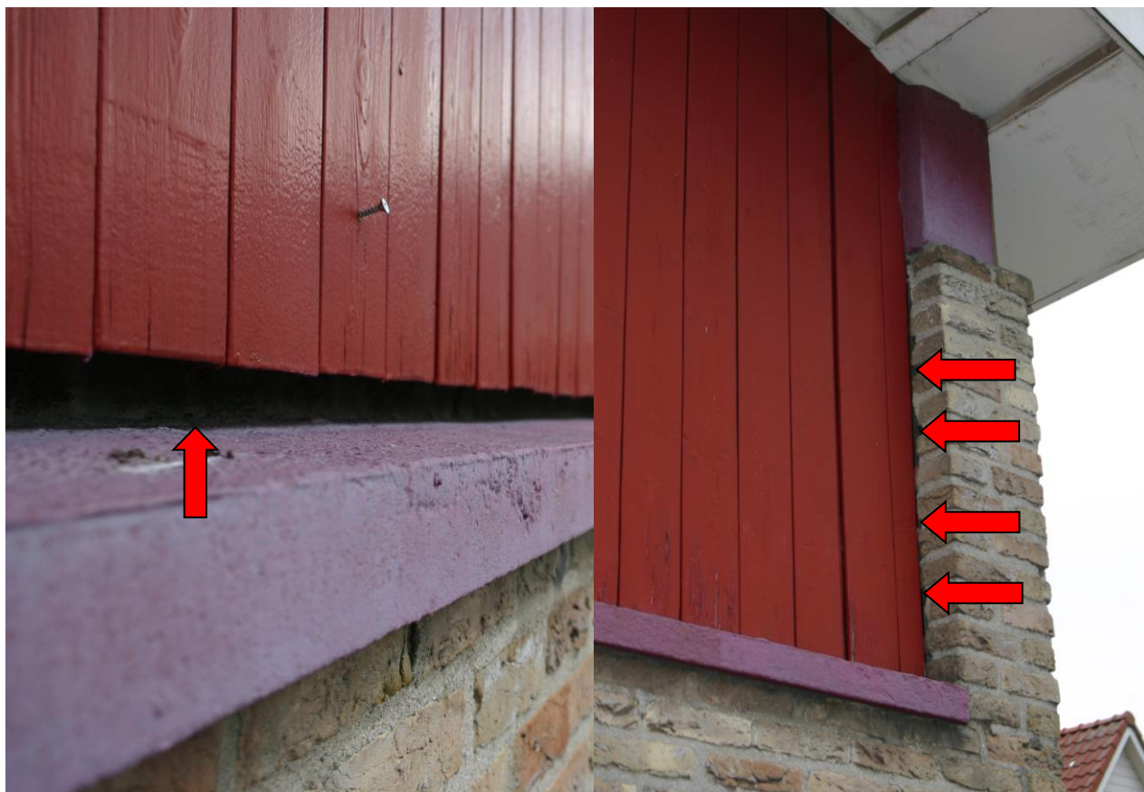
Figuur 4.2.3. Er zitten verschillende gaten en kieren (rode pijlen) in de zuidgevel, waardoor vleermuizen de ruimte achter de betimmering (foto links) en de spouwmuur (foto rechts) kunnen bereiken.
