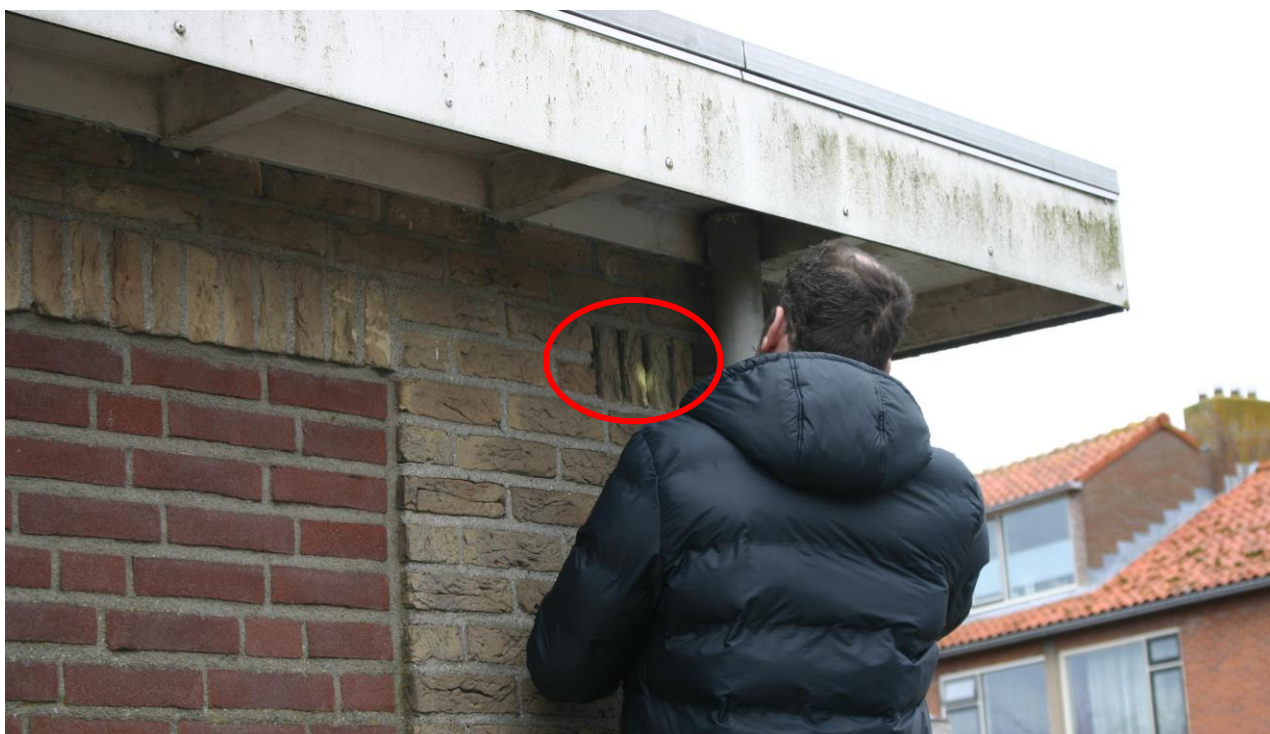
Figuur 4.2.2. In de westgevel bevinden zich vijf ventilatiesleuven (rood omcirkeld). Uit inspectie blijkt dat hierin geen vleermuisuitwerpselen voorkomen.
