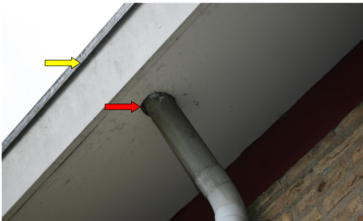
Figuur 4.2.1. Het hele dorpshuis heeft daktrimmen (gele pijl) die nauw aansluiten op de dakbetimmering. In de dakbetimmering zitten verschillende kierende openingen voor de regenpijp (rode pijl).
