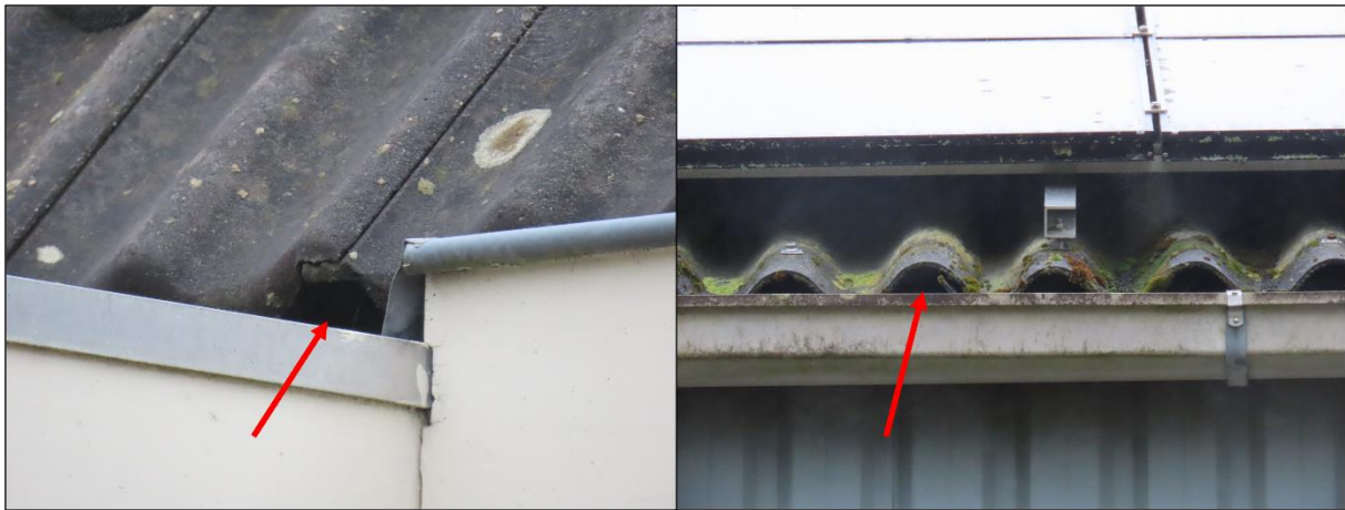
Figuur 2.3. Onder gegolfde dak- en nokpannen op de woning en onder de gegolfde dakplaten op de loods op de boerderij naast de bietenopslag werden voor huis- en ringmussen geschikte doorgangen tot nestgelegenheid aangetroffen.
