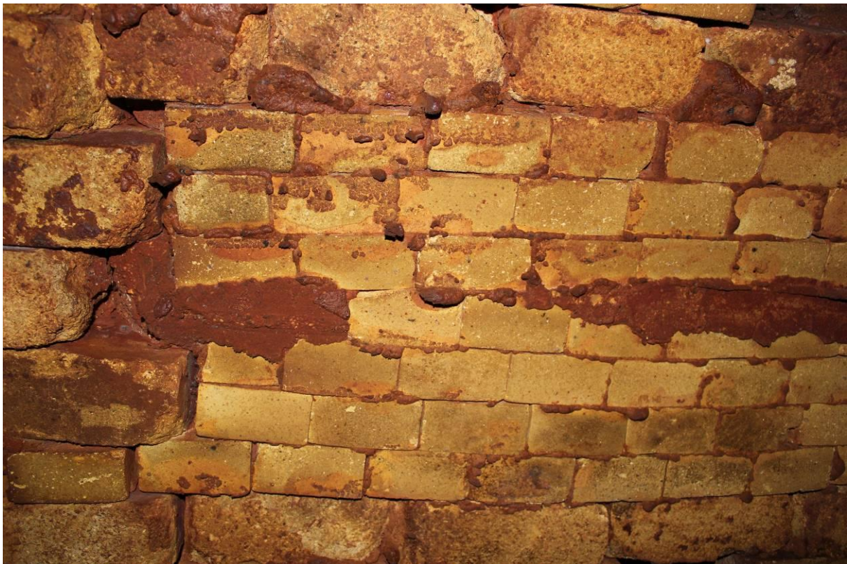
De binnenzijde van de ringoven gemetseld met chamottesteen en vuurvast rode cement. Er zijn diverse herstellingen te zien.
