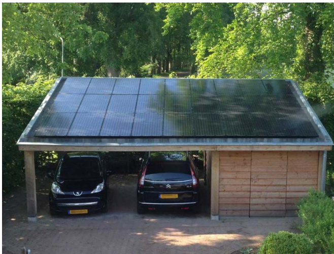
Zonnepanelen op een bijgebouw
