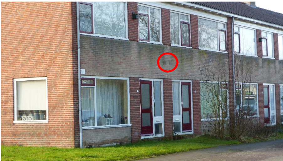
Figuur 4.5 Open stootvoegen (rode cirkel) in de voorgevel van de woningen.
