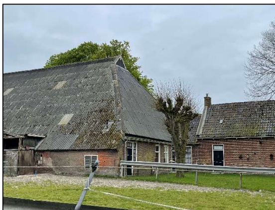
Stal met asbest dak en open uilenbord.
