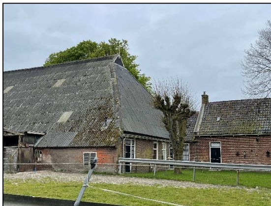
Afbeelding 2.3. Stal met asbest dak en open uilenbord.
