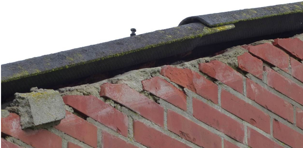
Figuur 4.4 Er is ruimte aanwezig tussen de golfplaten en de muur.
