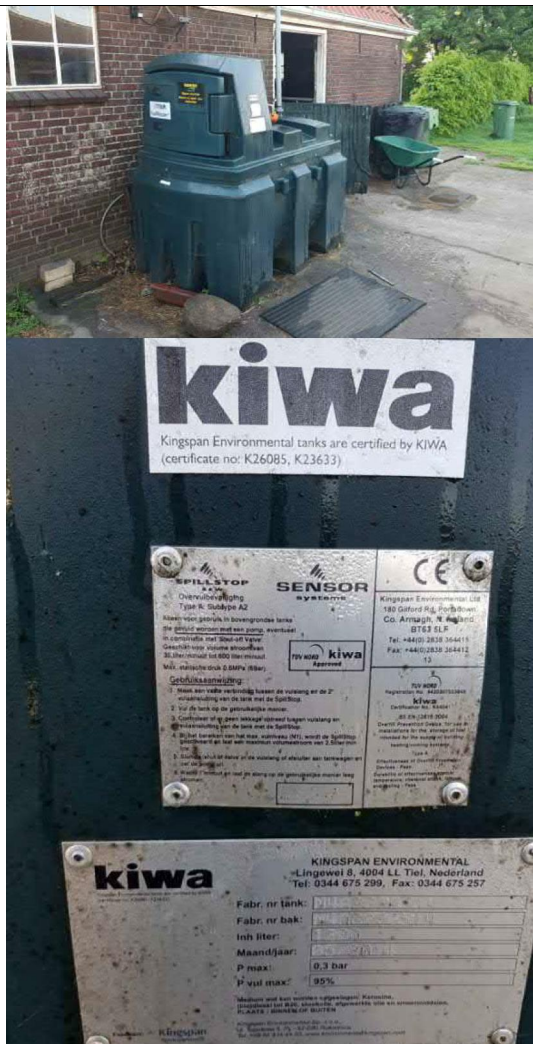
Achterzijde boerderij, bovengrondse olietank (geplaatst 2014)
