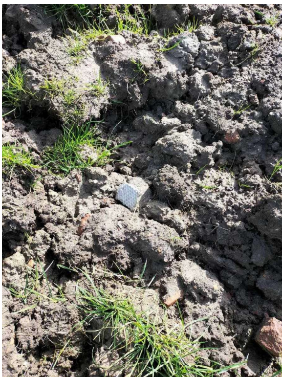
Foto 6: asbestverdacht materiaal t.p.v. inspectiegat G5
