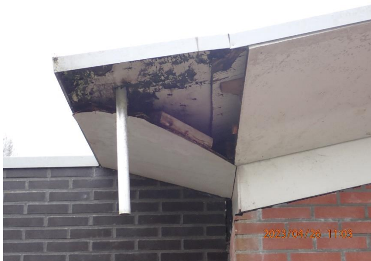
Figuur 5 Beplating onder het dakoverstek hangt los. Hierdoor zouden huismussen naar binnen kunnen kruipen en een nest aan kunnen leggen.
