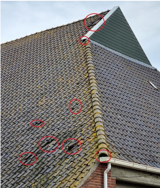
Figuur 24: Zicht op het dak van object B met rood omcirkeld diverse opgewipte pannen of gaten in het dak.
