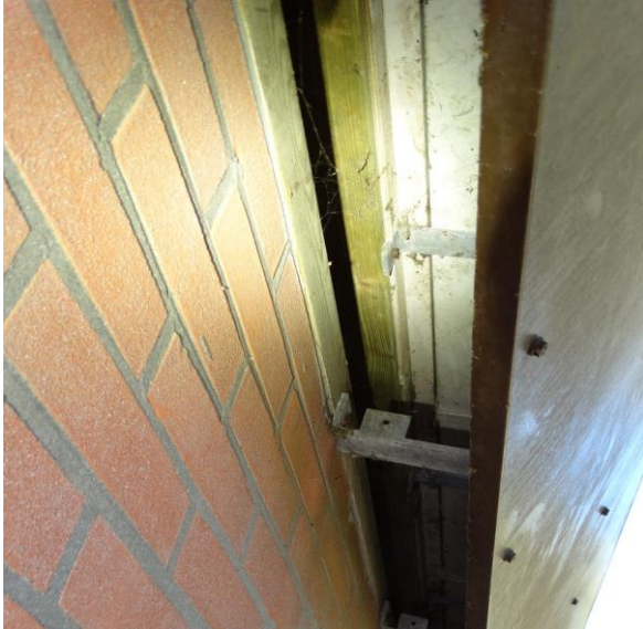
Figuur 15: Onder de dakgoot van stal B is een brede kier zichtbaar die toegang geeft tot het stuk erachter.
