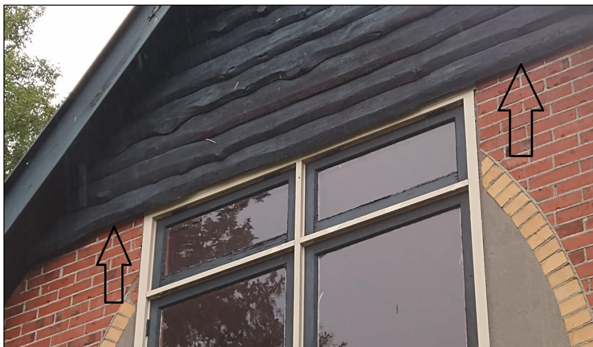
Figuur 2.2. Voor vleermuizen geschikte ruimte achter gevelbetimmering.
