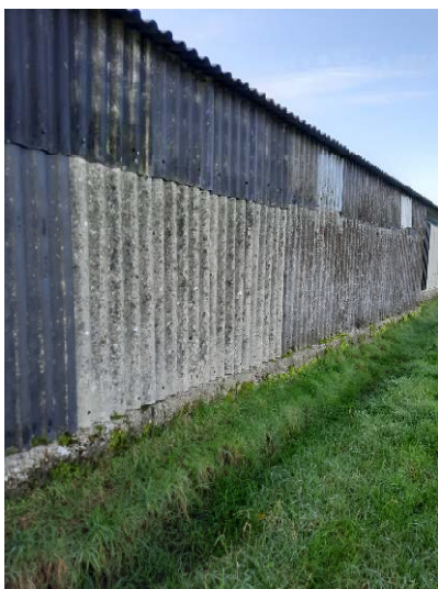
Foto 5.1: asbestverdachte gevelbeplating noordelijke loods
