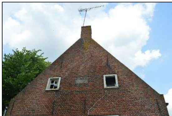
Afbeelding 1.4. Kapotte ramen op eerste verdieping aan zuidzijde woning.
