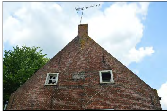
Afbeelding 2.3. Kapotte ramen op eerste verdieping aan zuidzijde woning.
