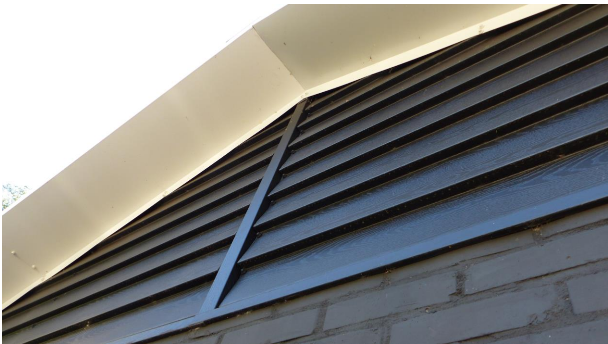
Figuur 4.4 Ook op de kopgevels is geen toegangsmogelijkheid voor vleermuizen.
