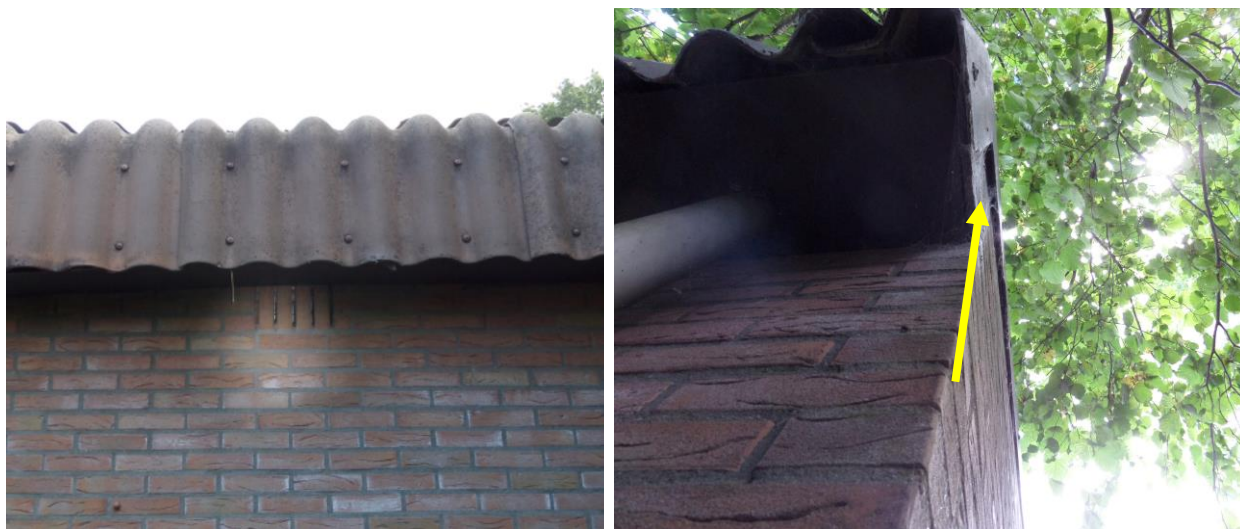
Foto 6 Open stootvoegen in het bijgebouw (links) en een kier bij het dak (rechts).
