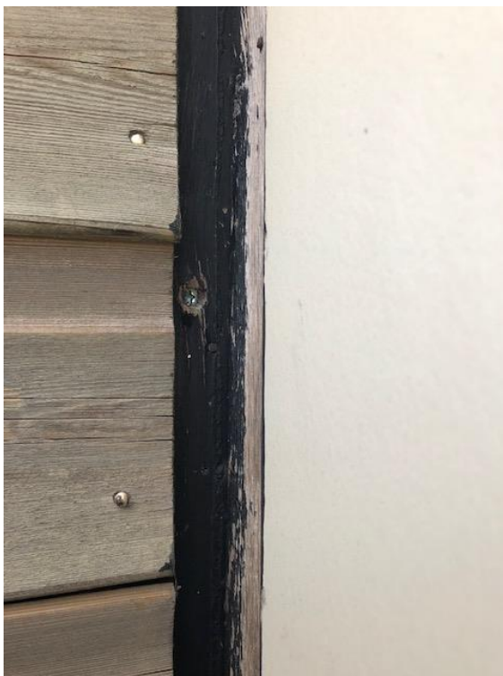
Foto 5 Geen openingen achter de gevelbetimmering.
