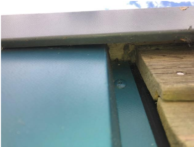
Foto 4 Geen openingen onder het ijzeren dak overstek.
