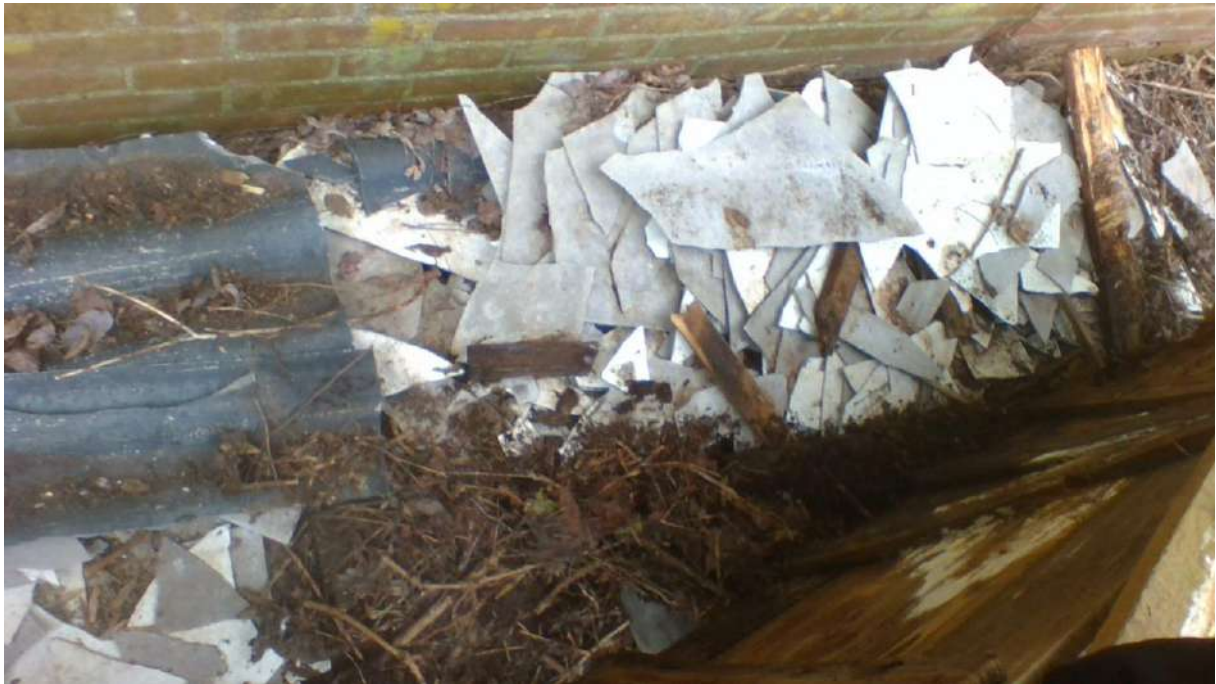
Foto 1 (inspectiegat 08 asbest naast loods)
