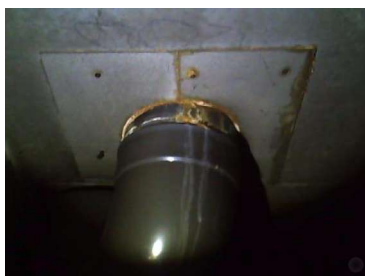
Foto 6. Asbesthoudende beplating om rookgasafvoer en ontluchting (voorgaand onderzoek)
