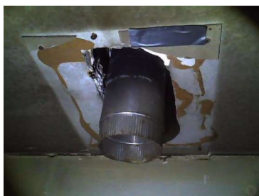
Foto 5. Asbesthoudende beplating om rookgasafvoer en ontluchting (voorgaand onderzoek)
