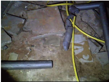
Foto 13. Losliggende plaat cv-ruimte
