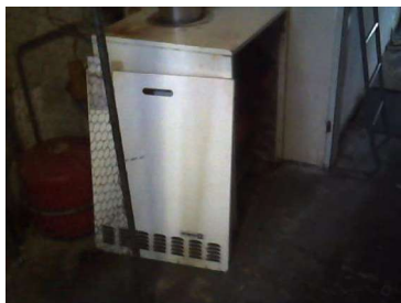
Foto 1. Asbesthoudende Atag cv-ketel
