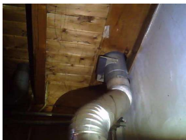
Foto 3. Asbesthoudende loshangende beplating (voorgaand onderzoek)
