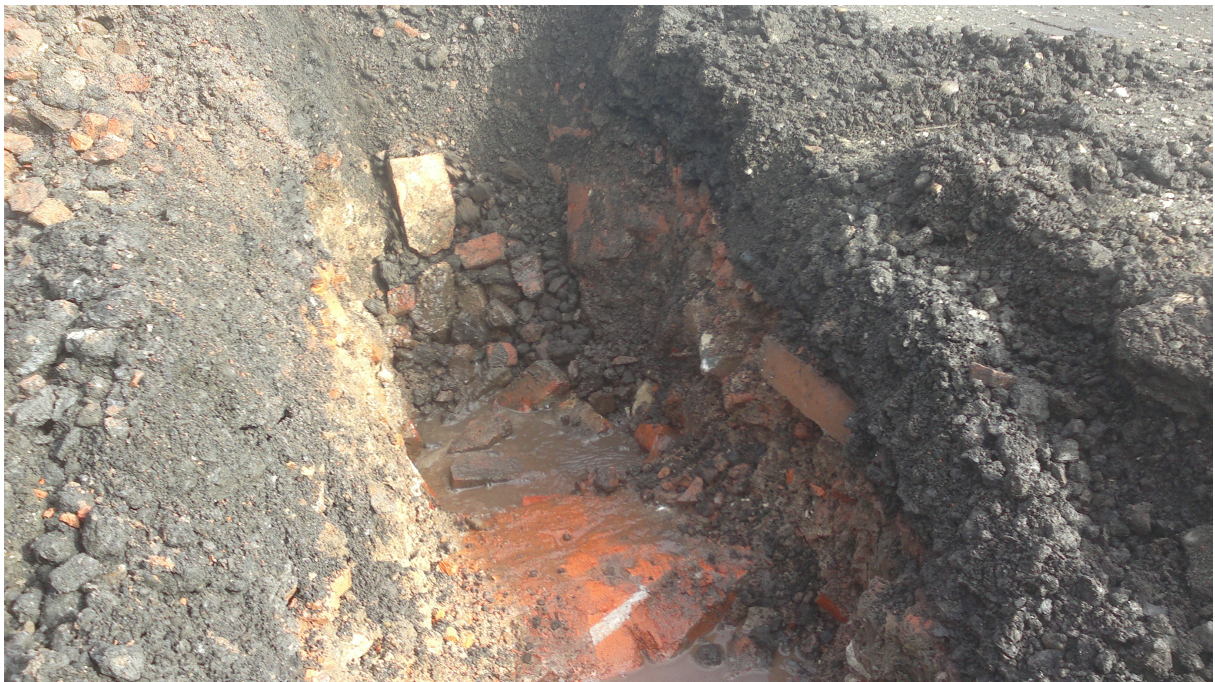
Foto 6. Slakken en puinlaag.
