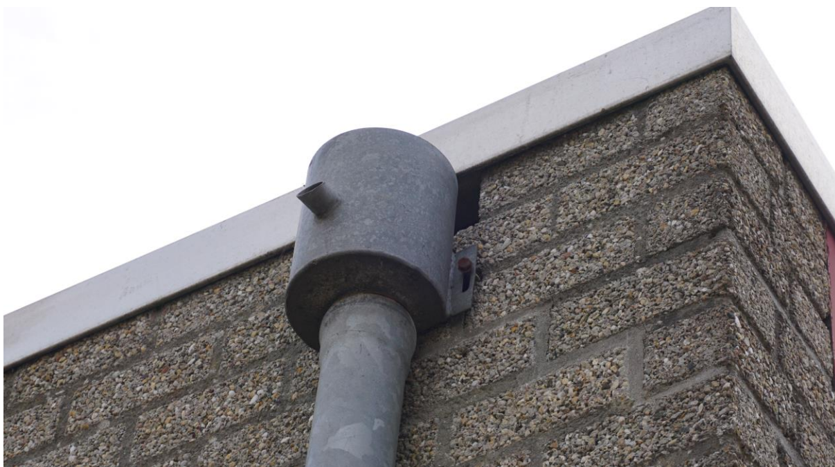
Figuur 4.5 Achter de regenpijpen van het hoofdgebouw ontbreken bakstenen, waardoor openingen voor vleermuizen aanwezig zijn om de spouw en/of het dakvlak te bereiken.
