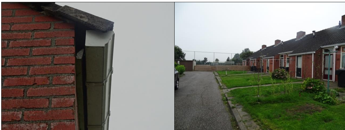
Foto's 3 en 4. Links de rand onder de dakgoot van één van de woningen. Rechts het aanzicht op het westelijke huizenblok vanuit het noorden.
