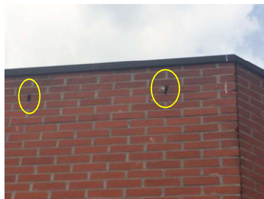
Foto 6 Open stootvoegen in de gevel.
