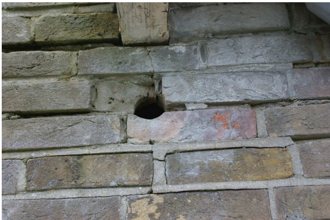
Figuur 5.2 Gaat in spouw aan westzijde loods Industrierweg 1
