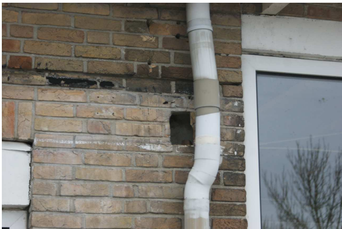
Figuur 5.3 Gat in spouw aan straatzijde Industrierweg 1
