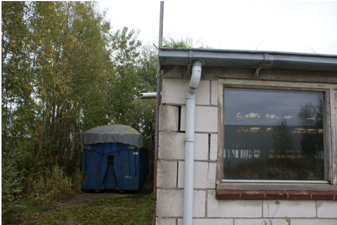
Figuur 5.4 Scheur in muur Industrieweg 1a
