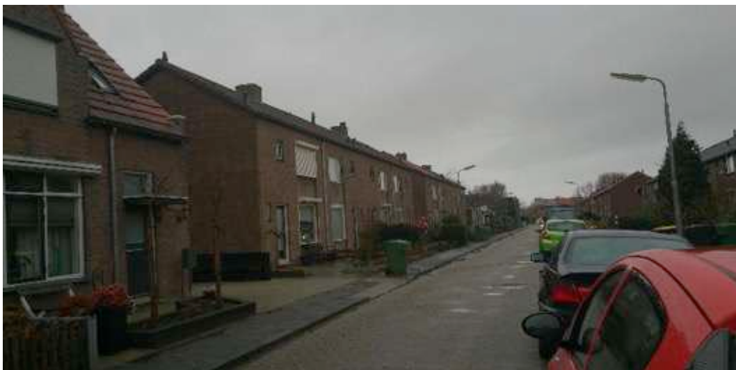
Figuur 39 Bij vrijwel alle blokken zijn kieren aangetroffen bij de kant- en nokpannen en zijn tevens spouwventilatieopeningen aanwezig.
