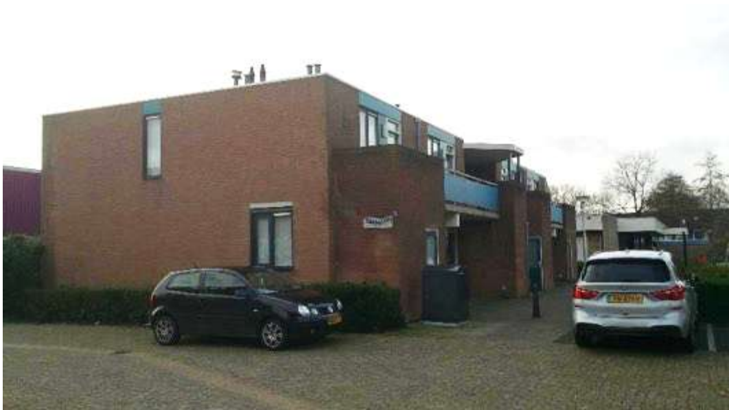
Figuur 11 Beide complexen beschikken over enkele open stootvoegen zonder toetredingssporen. Enkele centimeters boven maaiveld zijn rasters aanwezig ter ventilatie van de spouw.
