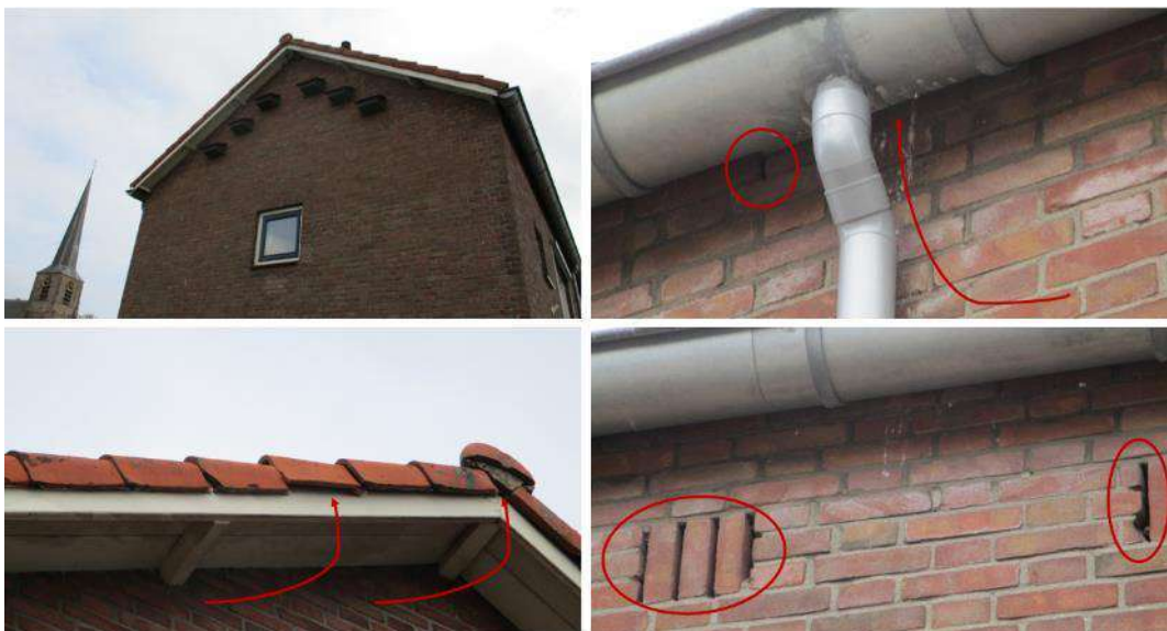
Figuur 25 Voorbeelden van potentiële invliegopeningen voor gierzwaluwen en vleermuizen in de rijtjeswoningen. Tevens wijzen de krijtsoren tegen de gevel op aanwezigheid van een (oud) gierzwaluwnest en is de onderste rij dakpannen ontoegankelijk voor huismussen door de aanwezigheid van vogelschroot.
