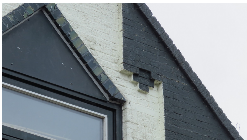
Afbeelding 12: In het geveloppervlak zijn geen overhangende randjes aanwezig met kieren waaronder vleermuizen kunnen wegkruipen.
