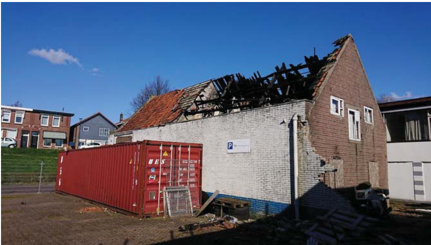
Afbeelding 4: De Ooststraat 80, het verbrande gebouw.
