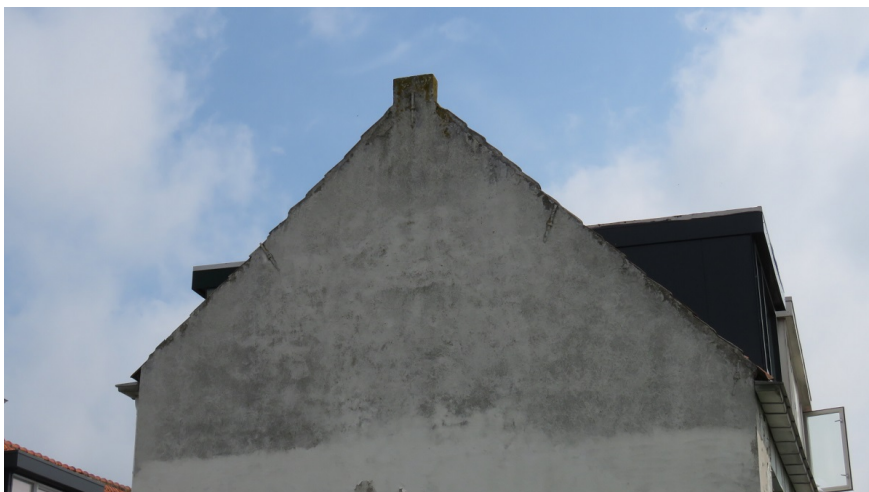
Afbeelding 7: Geveldetail woning aan oostzijde: metselspecie onder de dakpannen langs de dakrand.
