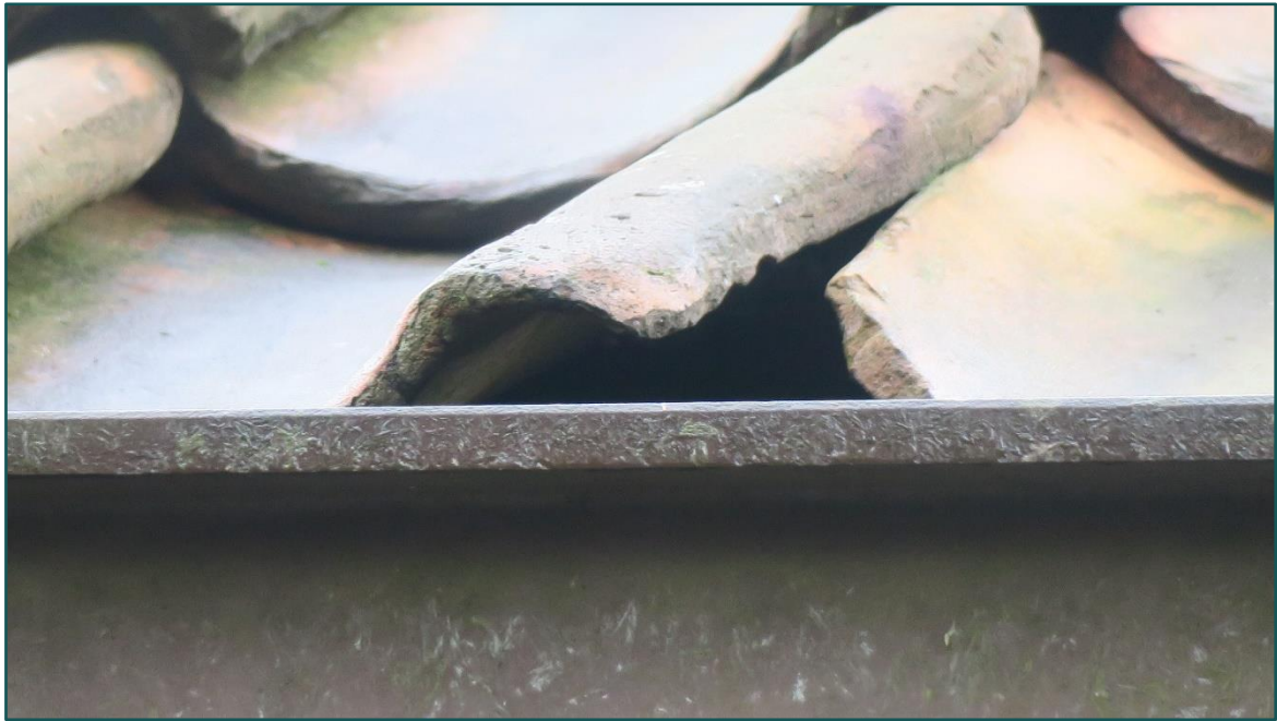
Figuur 3 Er zijn meerdere scheefliggende dakpannen aanwezig die toegang geven onder het dak.
