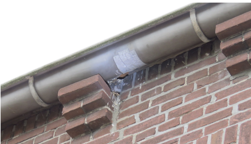
Afbeelding 8: Uitwerpselen bij een opening in de gevel. In dit geval gaat het vermoedelijk om een spreeuwnest, maar huismussen en gierzwaluwen kunnen van dezelfde ruimtes gebruik maken.
