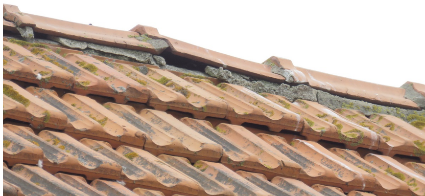
Afbeelding 9: Kier onder dakpannen bij daknok, een potentiële nestplaats voor gierzwaluwen.
