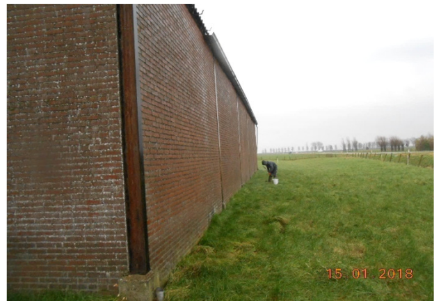
kapotte dakgoot bij schuur 1
