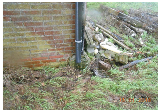
kapotte pijp nr 6, schuur 3
