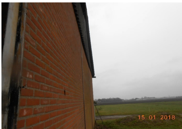
schuur 3, asbest-schot achterzijde
