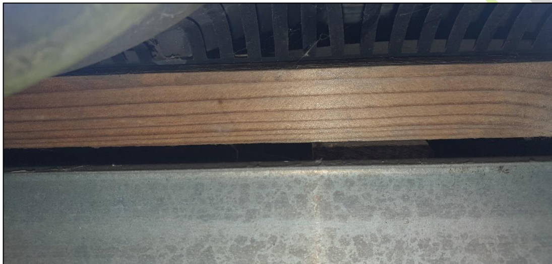
Figuur 8. Daklatten en vogelwering onder de onderste rij dakpannen van de garage. Foto: K. de Vries | Ecoresult B.V.
