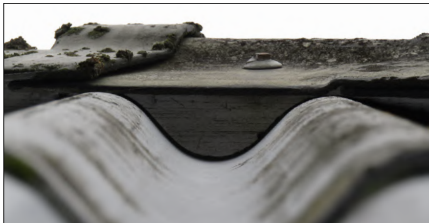
Figuur: op de nok van het dak zijn er boven de golfplaten geen openingen voor vleermuizen.
