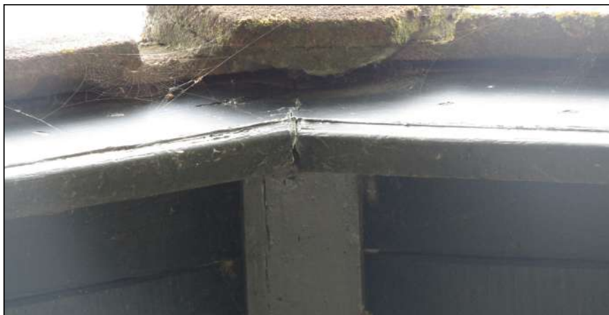
Figuur: de woning op perceel 44b heeft ruimte onder de nok- en kantpannen waar vleermuizen onder kunnen kruipen en de spouw of de ruimte onder de dakpannen kunnen bereiken.
