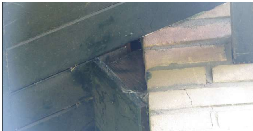
Figuur: het woonhuis op perceel 44b heeft openingen ter hoogte van de dakgoot waar vleermuizen en vogels, zoals huismus in kunnen vliegen.
