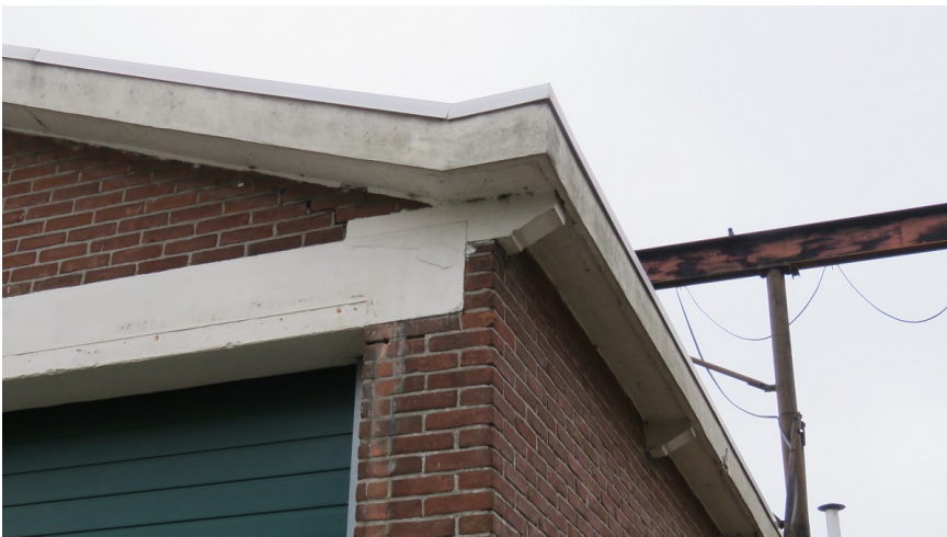
Afbeelding 9: De dakrandconstructie is ontoegankelijk voor vleermuizen, zie detailfoto.
