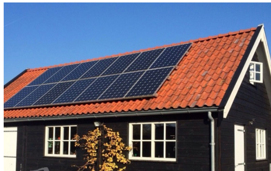
Voorbeeld zonnepanelen, gegroepeerd en uitgelijnd
