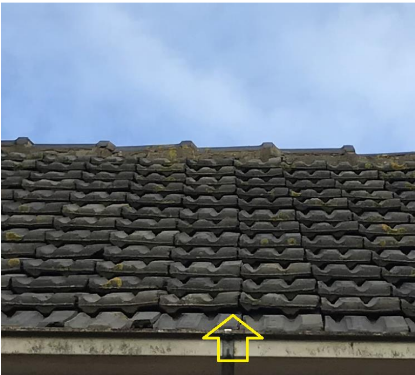
Figuur 11: Openingen onder dakpannen
