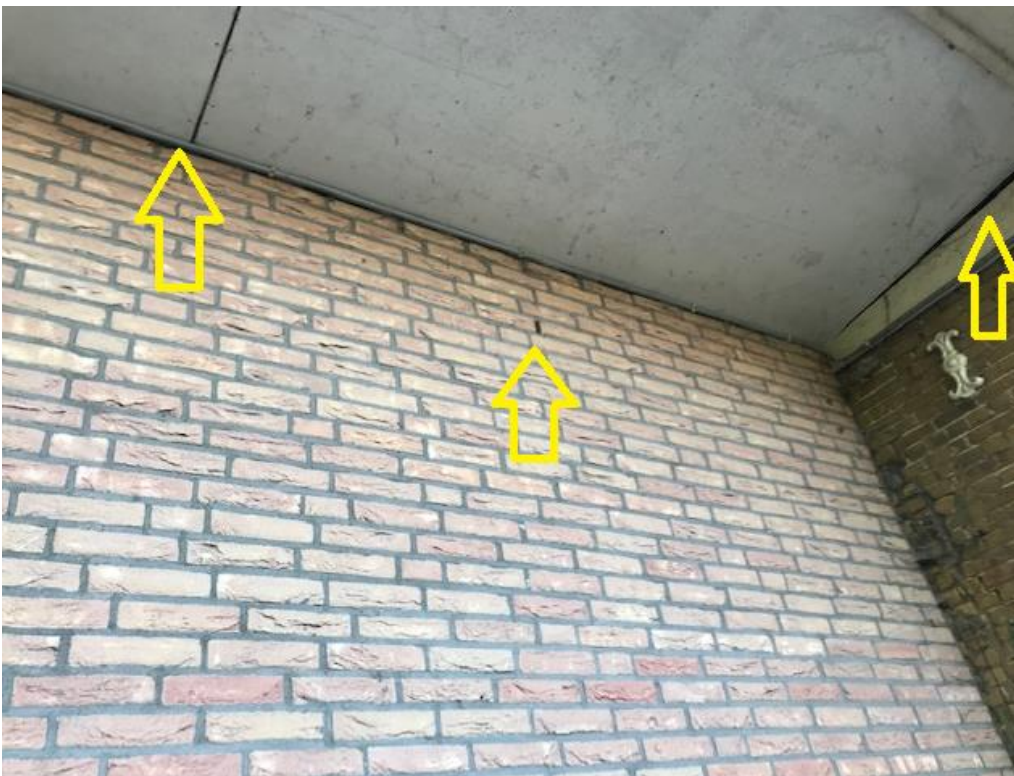
Figuur 15: Openingen achter plaatmateriaal en open stootvoegen
