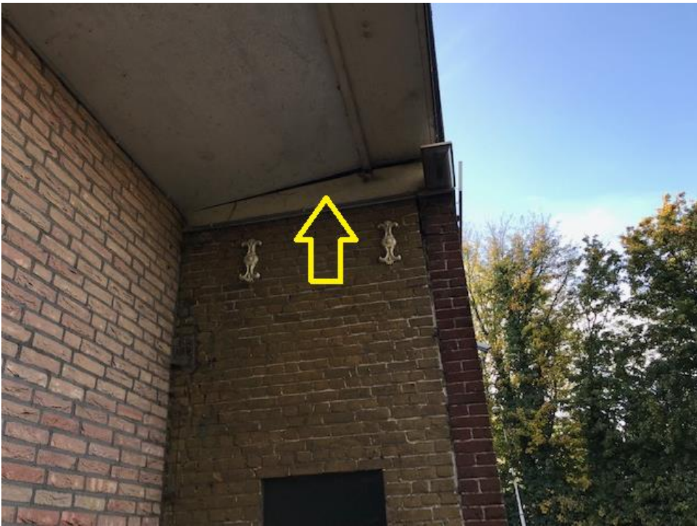
Figuur 14: Openingen achter betimmering
