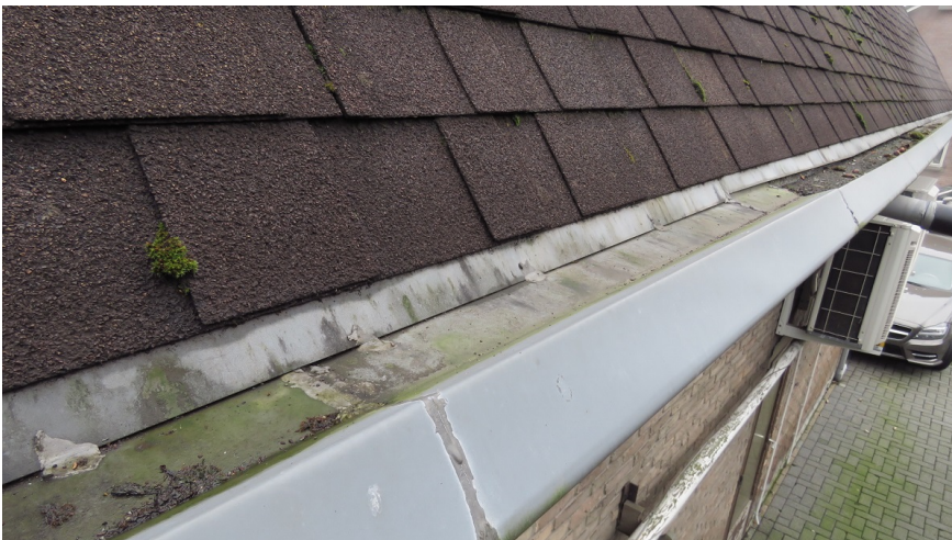
Afbeelding 8: De dakrand van de Margrietstraat 4, een volledig ontoegankelijk dakvlak.
