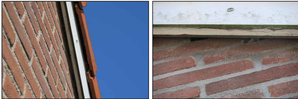
Figuur 4.13 Links: kierende kantpannen. Rechts: openingen tussen de gevel en de boeidelen.
