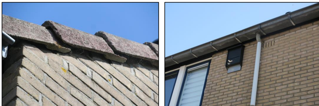
Figuur 4.16 Links: kierende kantpannen. Rechts aanwezige vleermuiskasten en open ventilatieroosters.
