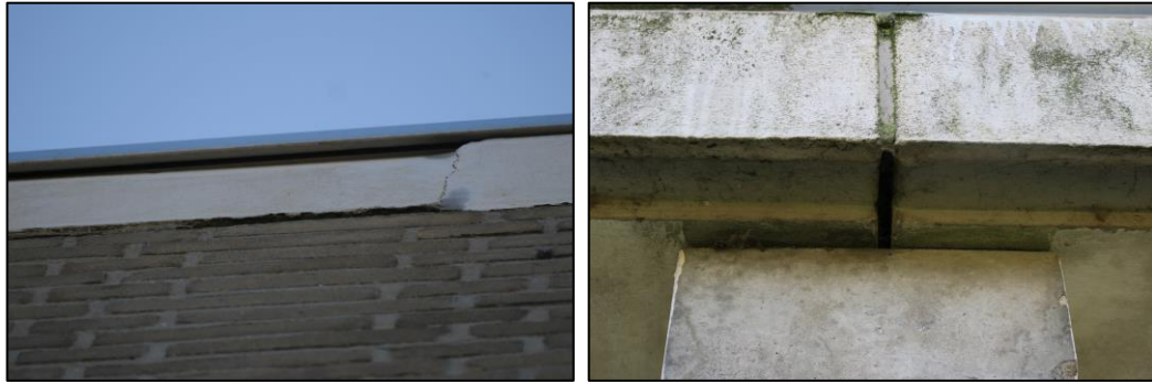
Figuur 4.10 Links: openstaande dakrand. Rechts: opening tussen de balkondelen aan de achterzijde van de flat.
