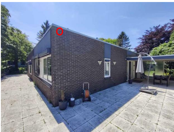
Figuur 14 Achterzijde woonhuis met stootvoegen (rood omcirkeld)
