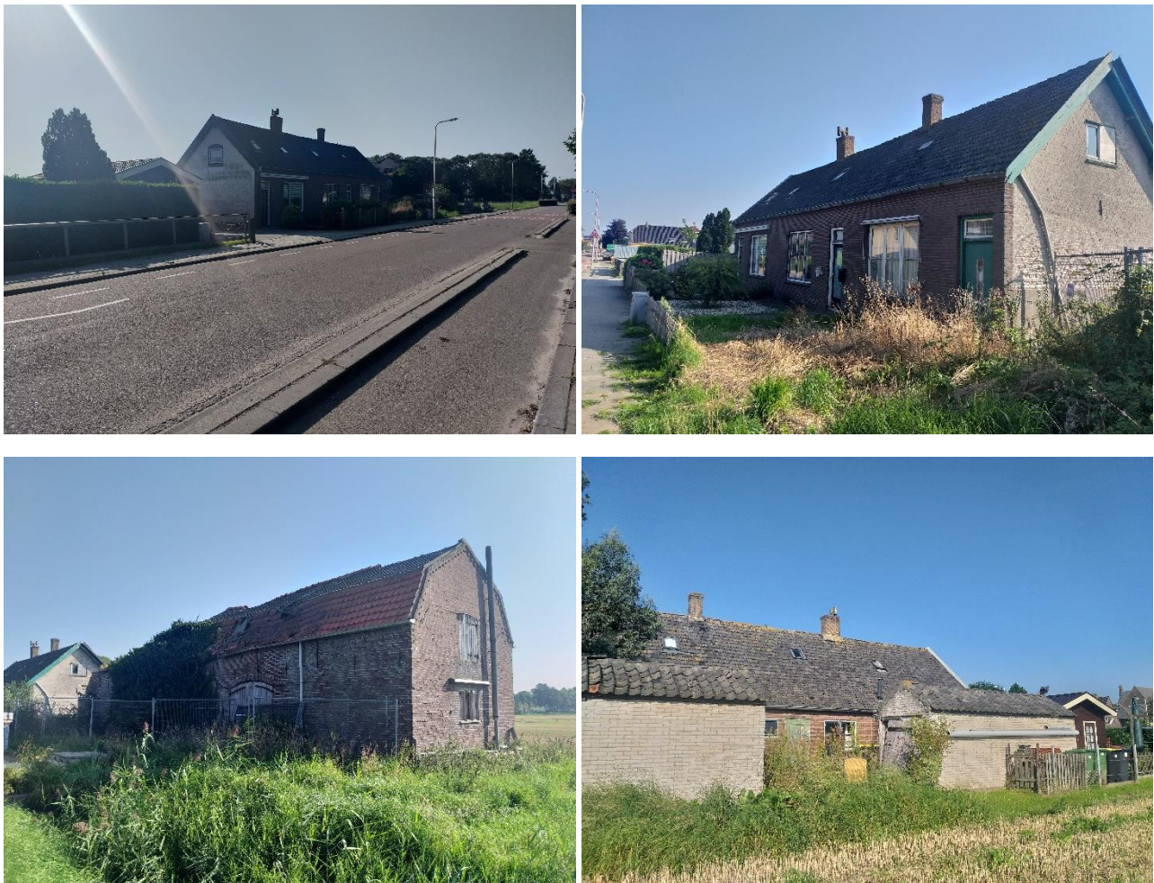
Figuur 2. Impressie plangebied. Linksboven overzicht van de woningen aan de Koninginneweg. Rechtsboven voorkant van de woningen met voortuinen vanaf nummer 21 gezien. Linksonder aanzicht vervallen woning nummer 23 met verwilderde tuin. Rechtsonder aanzicht achterkant woningen nummer 17 en 19 met stenen schuurtje en achterliggende vrijstaande garage.
