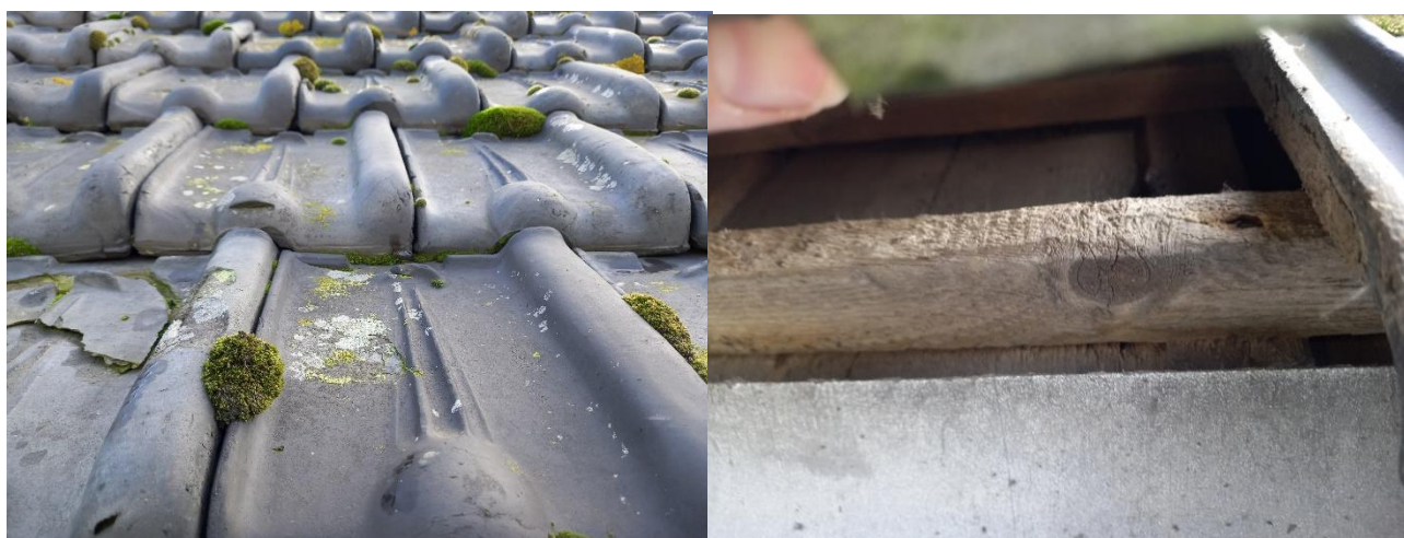
Figuur 3. Situatie onder de dakpannen. Links is zichtbaar dat dakpannen strak op elkaar aansluiten. Rechts is zichtbaar dat de dakpannen ieder op twee pannenlatten liggen.
