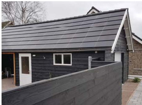
referentiebeeld dakopstelling zonnepanelen en -collectoren
