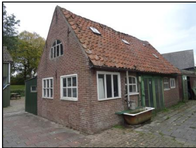
Figuur 6. Noordoostelijk aanzicht van de vervallen te slopen schuur op de onderzoekslocatie (fig. 12, oostelijk deel van gebouw D).
