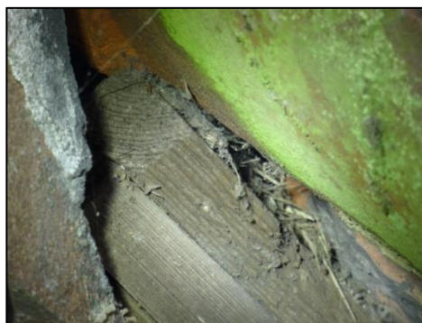
Figuur 14. Oud roodborstnest onder de dakpannen aan de noordgevel van de vervallen schuur D.
